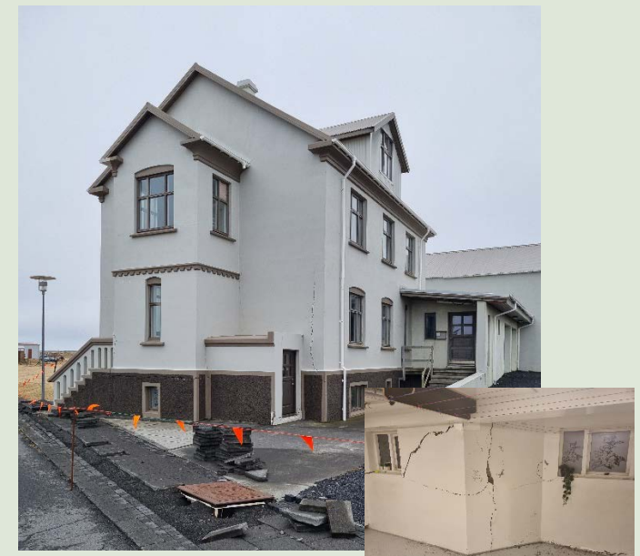
Mynd 14: Garðhús, Vesturbraut 10 er steinsteypt friðað hús byggt árið 1914 sem stórskemmdist í jarðskjálftunum haustið 2023. Búið var að gera húsið upp af miklum myndarbrag með styrk úr húsafríðunarsjóði.
