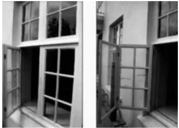
Tvöfalt fag. Nýr innri rammi er festur á ytri ramma með lömum og krókum. (Hægri mynd sýnir opinn innri ramma, vegna þrifa). Kirkjuvegur 5, Hafnarfirði, byggt 1922. Arkitekt Guðjón Samúelsson. Endurbætur 1993. Arkitekt Magnús Skúlason, Húsafriðunarnefnd.
